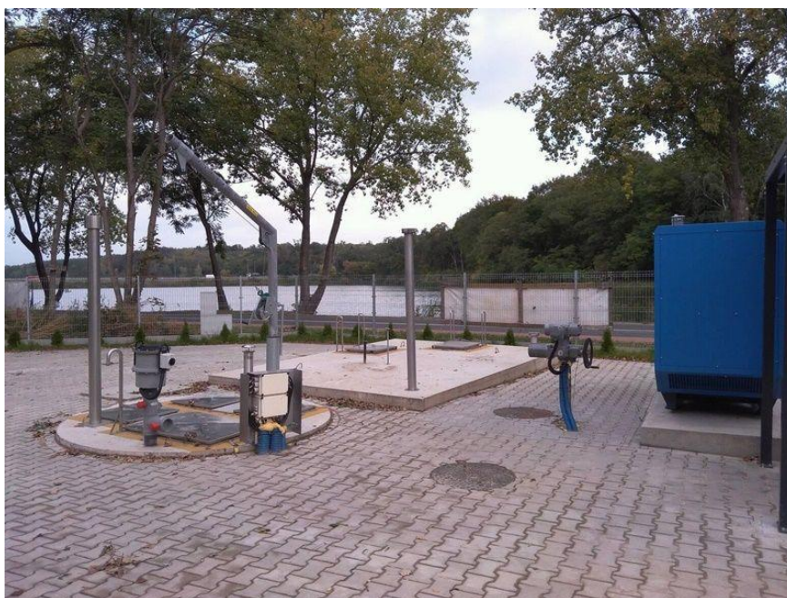
Fot 2. Przepompownia ścieków w Zegrzu
